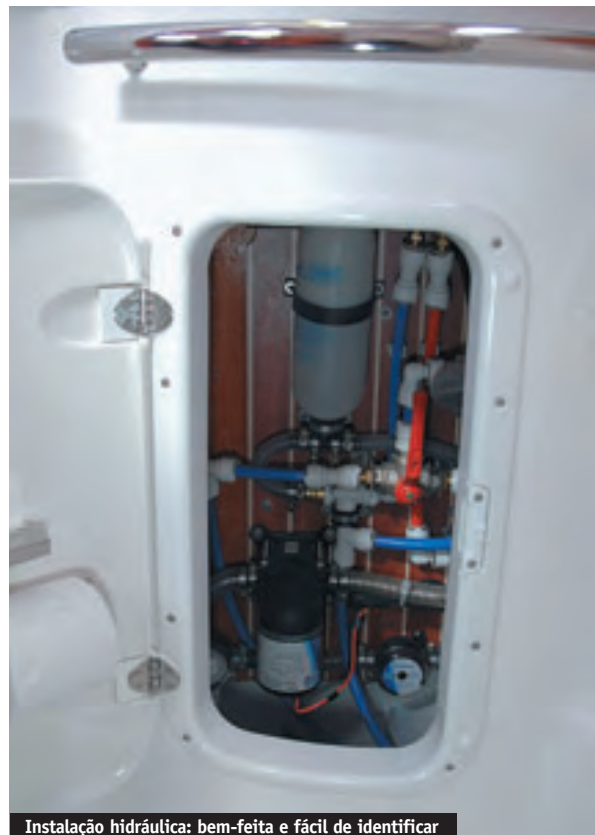
Instalação hidráulica: bem-feita e fácil de identificar
