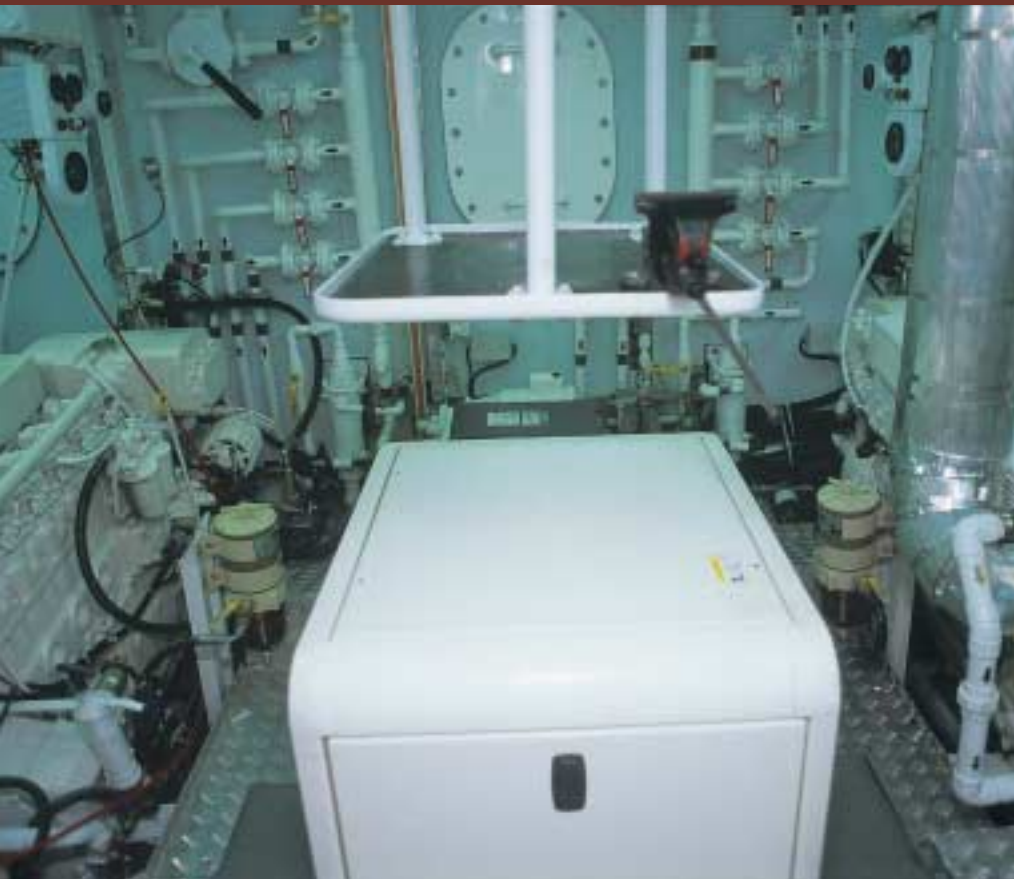
Bancada com morsa para pequenos reparos mecânicos na praça de máquinas
