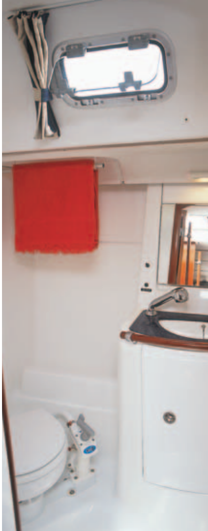
Banheiros têm água quente e fria
