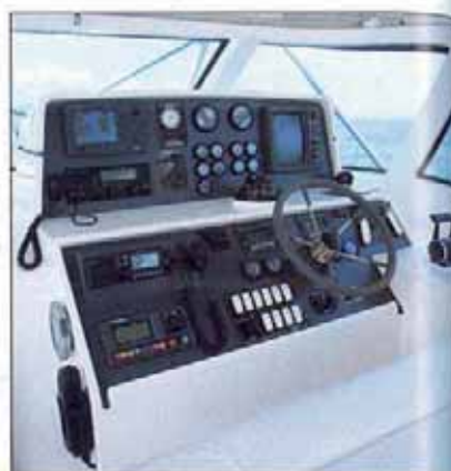
Painel Projetado com espaço adequado para os relógios do motor, eletrônicos e quadro de disjuntores
